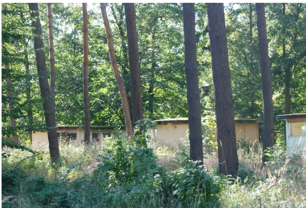
Fot. Widok na zniszczone domki rekreacyjne w terenie dawnego ośrodka sportów wodnych
