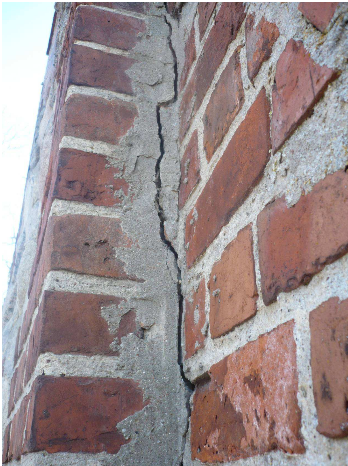
Fot. nr 4: Zbliżenie pęknięć widocznych na zdjęciu nr 3.
