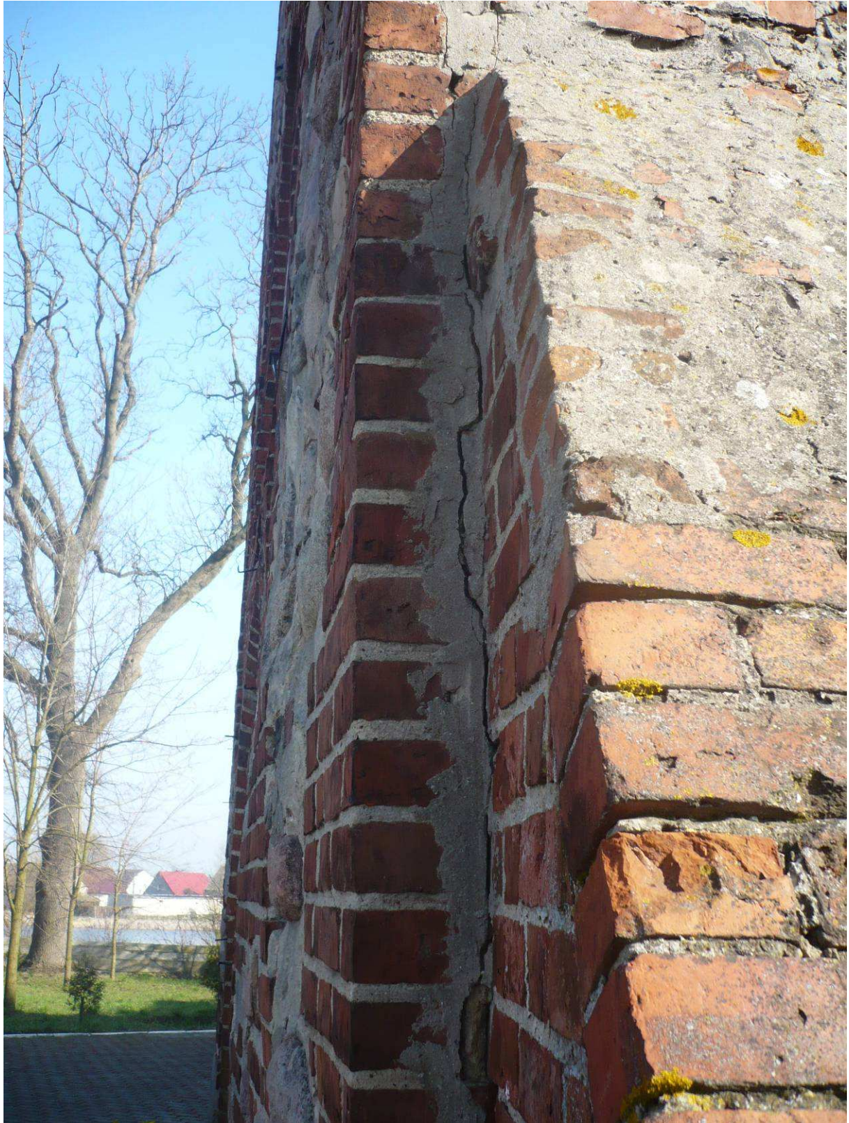
Fot. nr 3: Podobnie jak na fotografii nr 2 widać pęknięcia muru wieży Kościoła. Są również widoczne ubytki fug mocujące cegły i kamienie.
