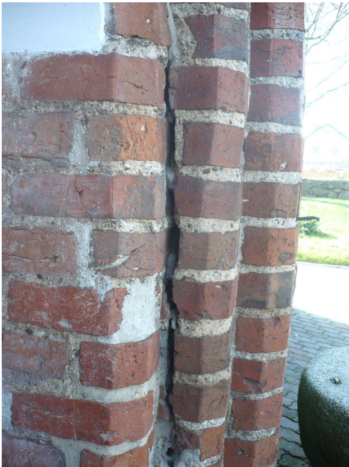
Fot. nr 2: Wejście do Kościoła – pęknięcia idące od wieży do fundamentów powodują odchylenie się muru przy drzwiach wejściowych.
